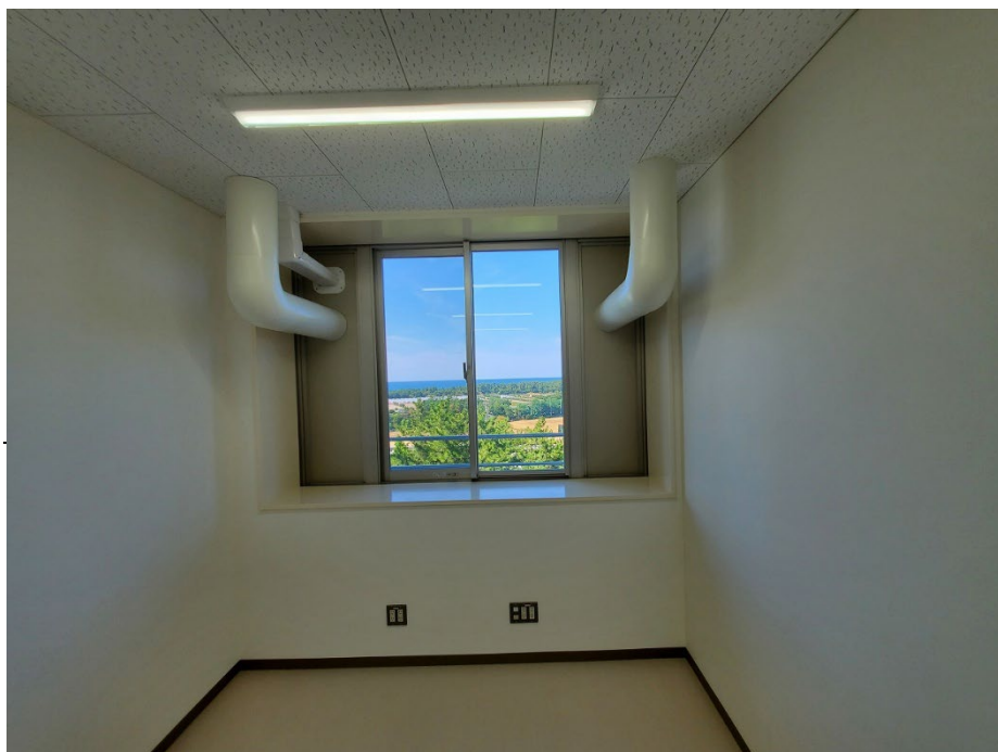
窓の左右に大きな配管が設置され、窓面積が大幅に縮小されただけでなく、書架の設置もできなくなった教員研究室
